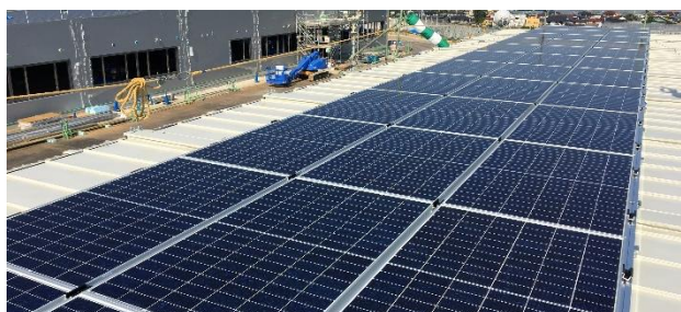
写真1 太陽光パネル設置状況
