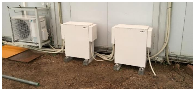
写真2 All-in-One蓄電池システム設置状況
